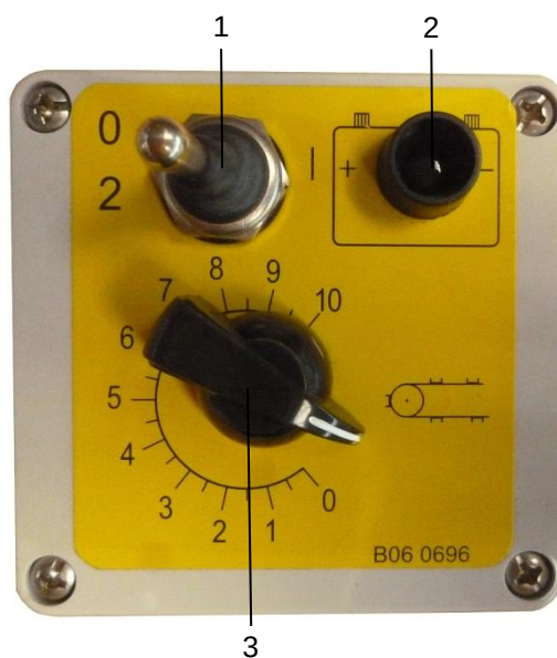
Kuva 96: Pohjakuljettimen sähkömagneettisen hallintalaitteen käyttöliittymä
